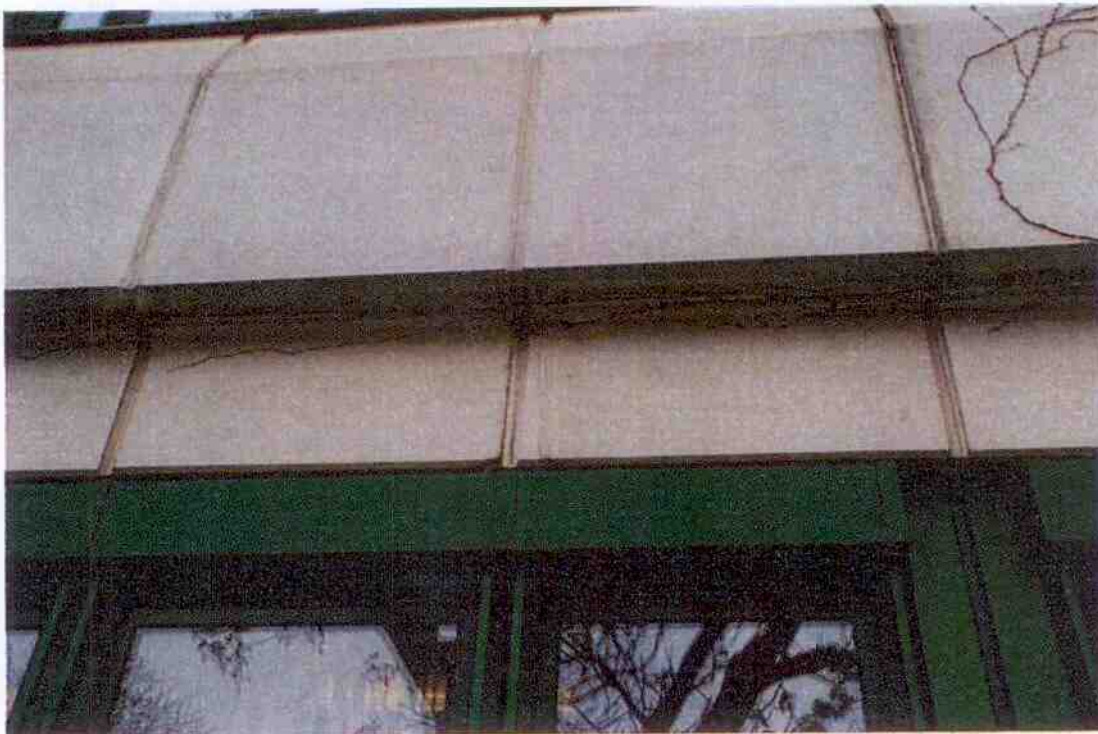
Bild 7: Fassaden-Situation, wie vor. Mühelos lässt sich optisch nachvollziehen, dass die elastisch verschlossenen vertikalen Element-Fugen nicht mehr ausreichend wirksam sind. Die eingedrungene Niederschlagsfeuchtigkeit ist unterseitig wieder ausgetreten (Aussinterung) und hat diverse Beschädigungen verursacht.
